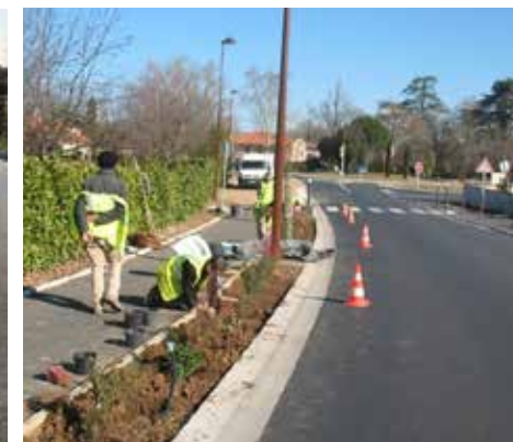
Mise en place d'une bordure plantée pour sécuriser les déplacements de cycles, Marssac-sur-Tarn (81)
